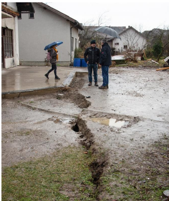
Slika 3 Pukotina nastala bočnim razmicanjem u naselju Bok Palanjački; registrirano 3.1.2021.
