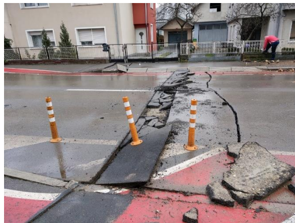
Slika 9 Oštećenje kolničke konstrukcije u Ul. Nikole Šipuća u Sisku. Uslijed likvefakcije izbačen je dio instalacija prema površini. Ovakvi primjeri brojni su u Sisku, Petrinji i Glini i okolici.
