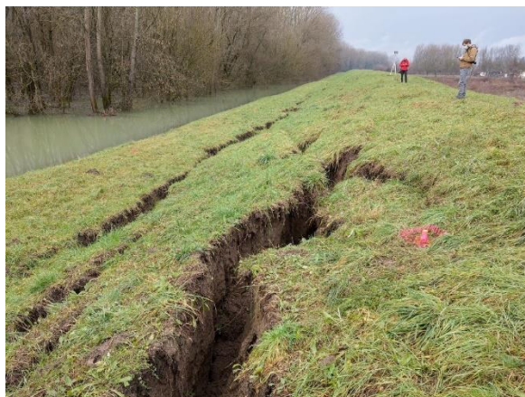
Slika 12 Pukotina na nasipu uz Savu u Galdovu, Sisak snimljena 3.1.2021. Pukotine su posljedica razmicanja tla. Lijevi dio na slici pomaknuo se prema Savi i nastale su vertikalne duboke pukotine.
