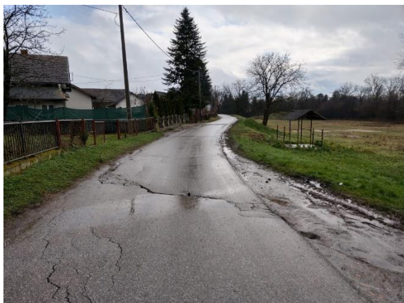
Slika 11 Pukotina na cesti u Boku Palanjačkom. Pukotina ulazi u naselje, a dio naselja pomaknuo se prema Savi (desno) za procijenjeno 30 cm.
